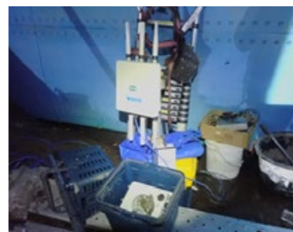
トンネル内のWi-Fi中継機
