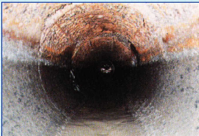
写真1 腐食による鉄筋の露出
